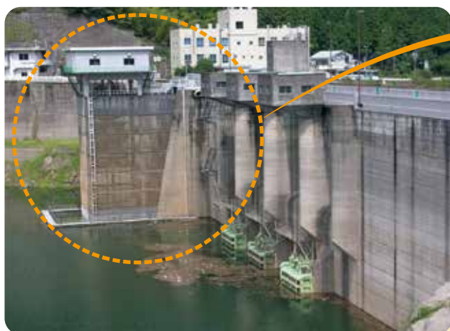
松原ダム選択取水設備
