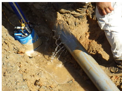
老朽化した上水管
