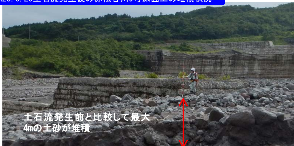
H28. 6. 20土石流発生後の赤松谷川9号床固工の堆積状況
