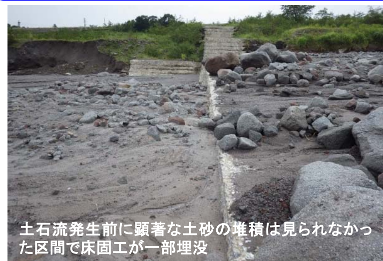
H27. 8. 25土石流発生後の赤松谷川6号床固工の堆積状況
