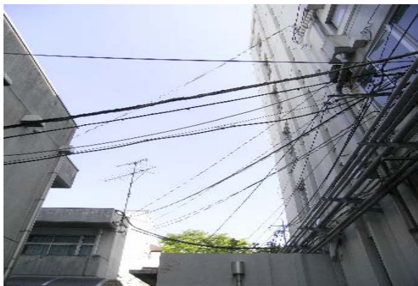
写真4 エレベータ棟、架空線状況
