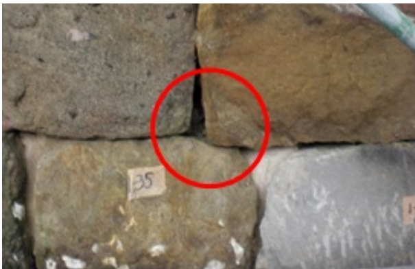
写真11 目地奥に設置された水抜きパイプ
