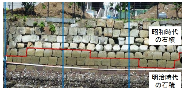
写真2 改修前の石積護岸状況
