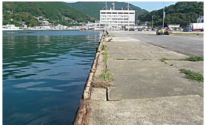
図-4 老朽化した岸壁
