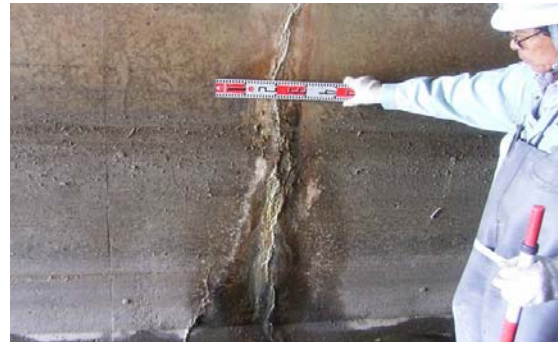
【老朽化した河川構造物の状況】
