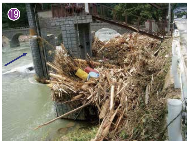
荒瀬堰に押し寄せたガレキ（7月3日出水）
