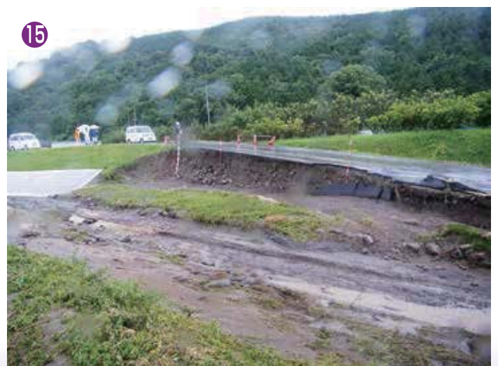
被災した護岸（7月3日出水）
