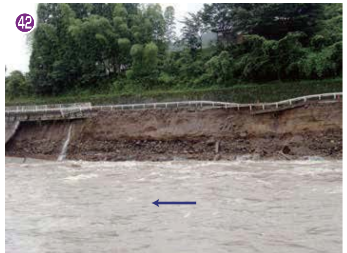
崩壊した護岸（7月14日出水）
