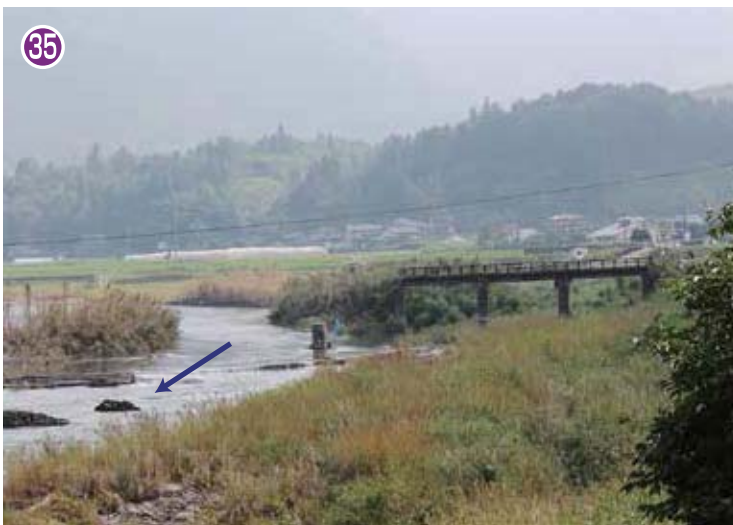
被災した水路橋 (7月3日出水)
