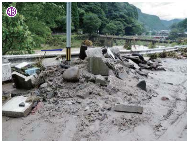
コンクリート製の側溝の蓋も流されて道路脇に堆積（7月3日出水）
