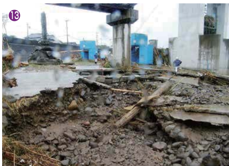
被災した大井手堰（7月3日出水）
