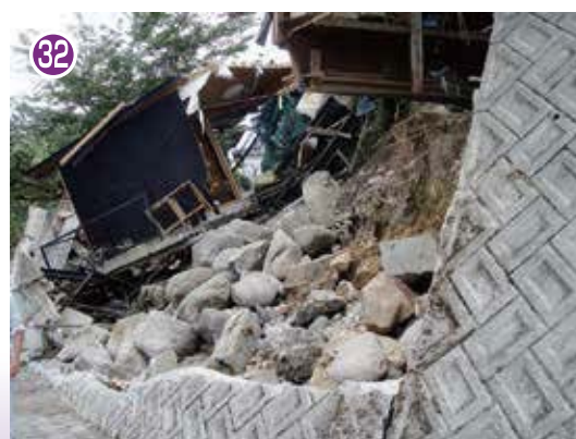
護岸と家屋の崩壊 (7月14日出水)
