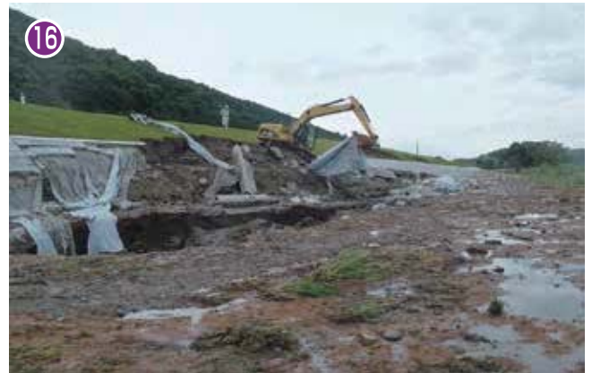
被災した護岸（7月3日出水）
