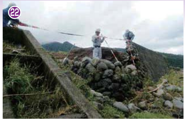
被災した護岸（7月3日出水）
