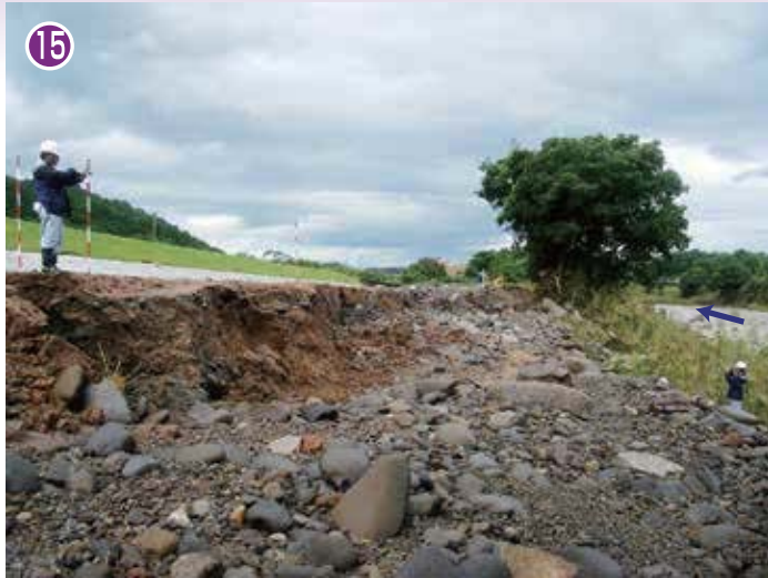
被災した護岸（7月3日出水）
