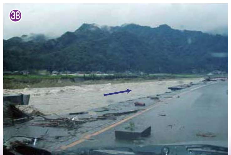
片側車線が崩壊している国道212号 (下戸原付近) (7月14日出水)
