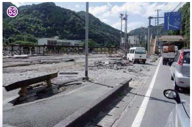
「耶馬溪中学校」前の駐車場のはがれたアスファルト（7月14日出水）
