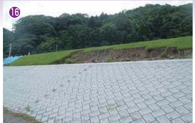
被災した護岸（7月3日出水）
