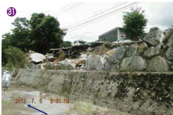
被災した護岸（7月3日出水）
