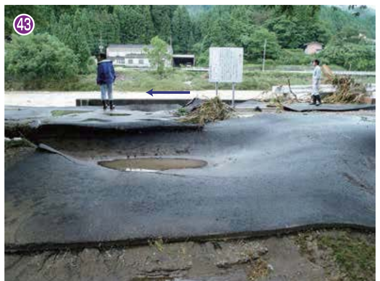
水が流れ波打っている舗装（7月3日出水）
