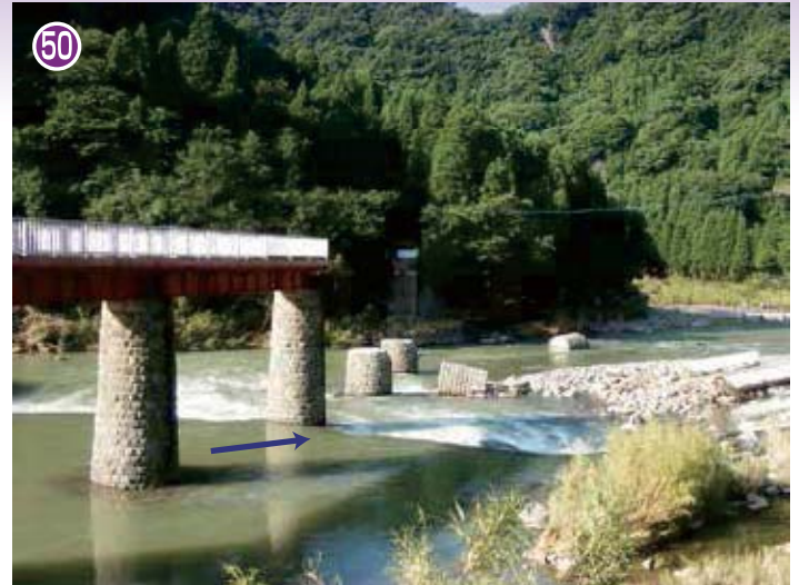
流された第二山国川橋（サイクリングロード）（7月3日出水）
