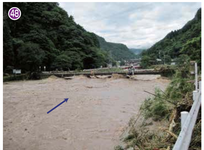
車や流木などが引っかかっている津民橋（7月14日出水）
