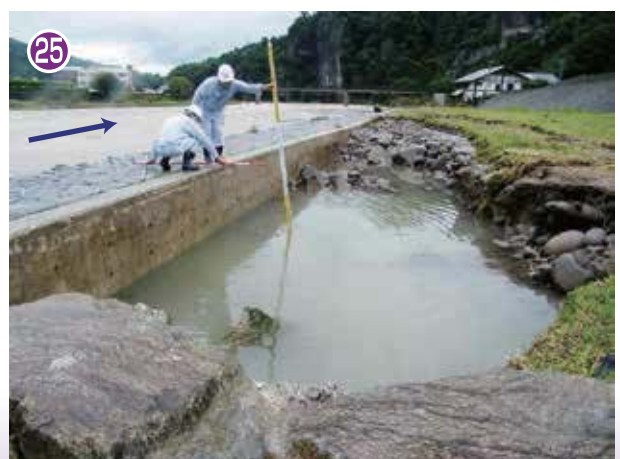
被災した護岸（7月3日出水）
