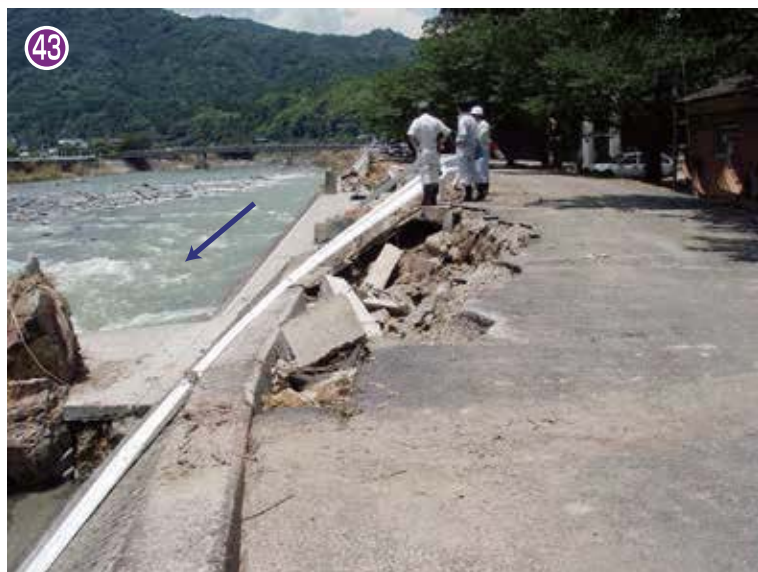
洗い流された護岸の裏（7月14日出水）
