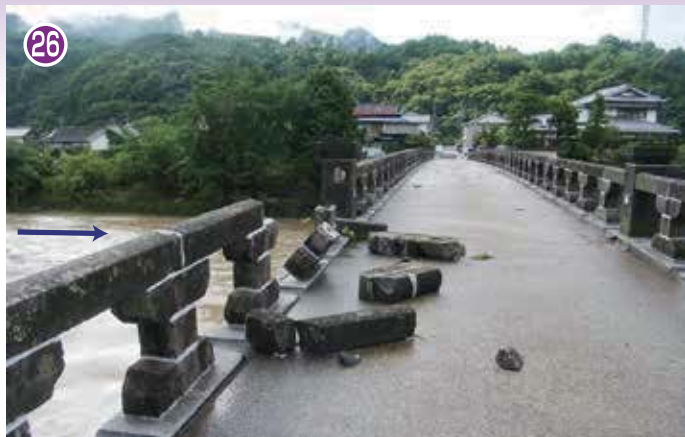
被災した羅漢寺橋（7月3日出水）
