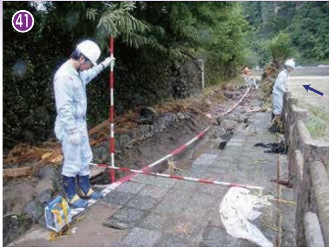
洗掘された遊歩道（7月3日出水）
