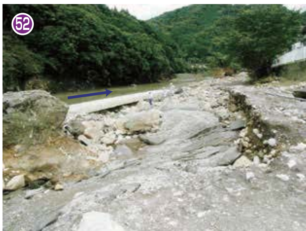
洗掘された護岸（7月3日出水）
