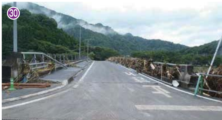
被災した早瀬橋（7月3日出水）
