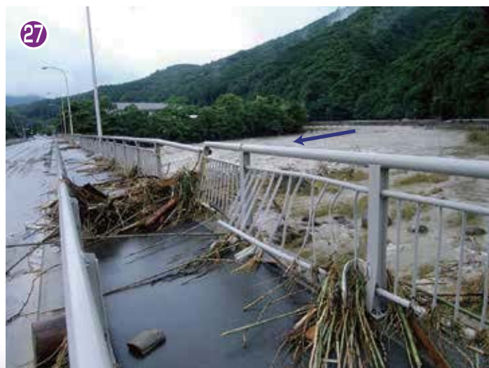
流木によって被災した高欄 (7月14日出水)
