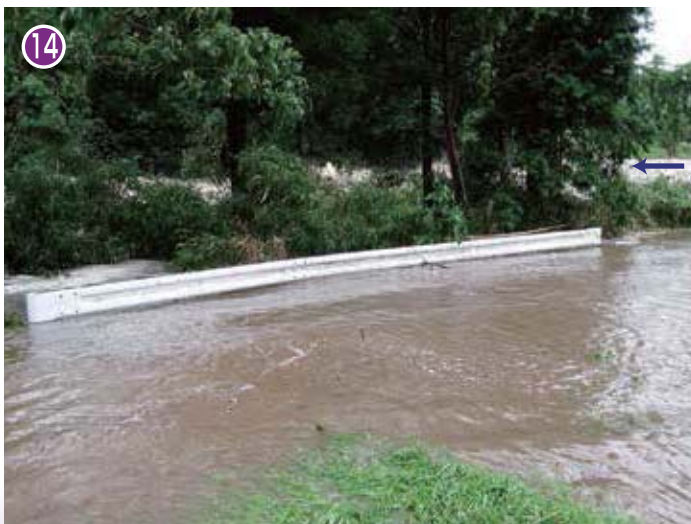
越水して田へ流れ込む水（7月14日出水）
