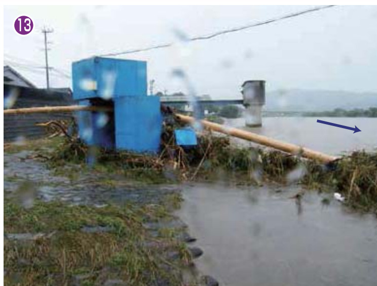
被災した大井手堰（7月3日出水）
