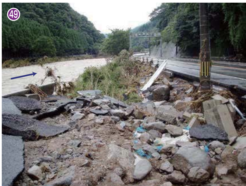
「やばの駅」駐車場のはがれたアスファルト（7月3日出水）
