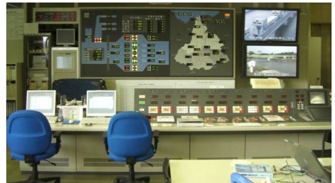
山国川河川事務所内操作室
