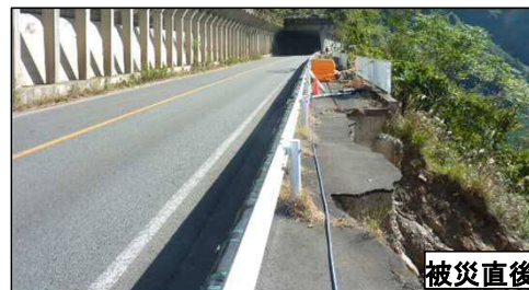
被災箇所③
