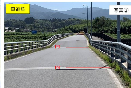
▲車道部の変形状況(P8→P9方面)
