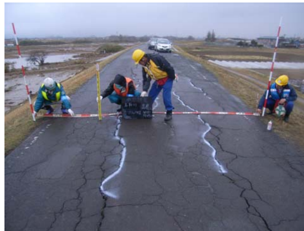
堤防亀裂被災調査状況
