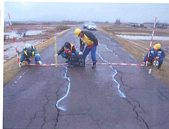
堤防亀裂被災調査状況
