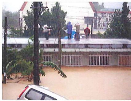
奄美市住用 総合支所 浸水被害状況
