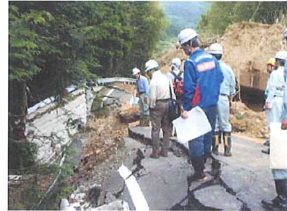
学識者、整備局職員による被災調査 国道498号【佐賀県伊万里市】
