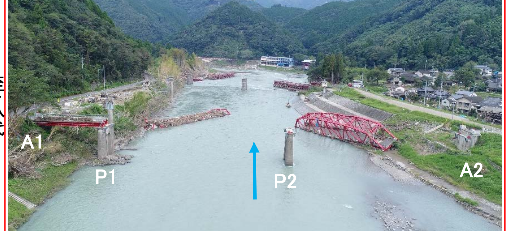
被災後の状況(上部工流失状況 P1~A2間)
