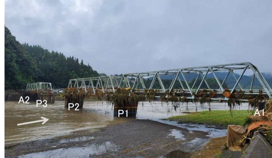
被災後の状況(上部工流失状況 P2～P3間)
