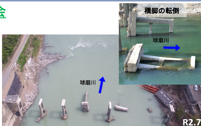
【被災全景写真（神瀬橋）】
