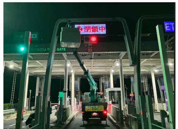
＜ETC 設備工事＞
