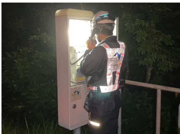
＜非常電話設備点検＞
