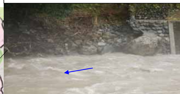
川辺川・護岸一部欠損
