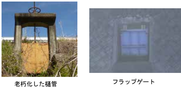
老朽化した樋管
