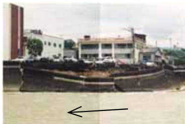
河床洗掘により発生した護岸崩壊 (球磨川右岸61k300付近)
