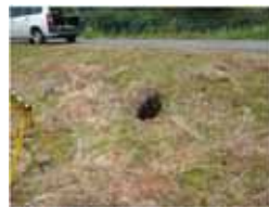
巡視で確認された堤防陥没
