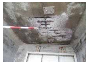
老朽化により鉄筋が露出した樋管
