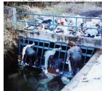
除塵機への廃棄物流入
