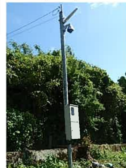
河川監視カメラ設置 (相良村)
