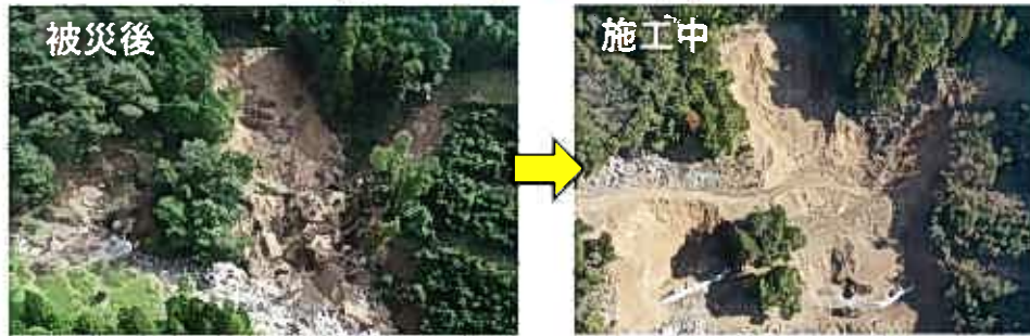
民有林内の国の直轄代行による災害復旧工事（芦北町 南迫地区）
