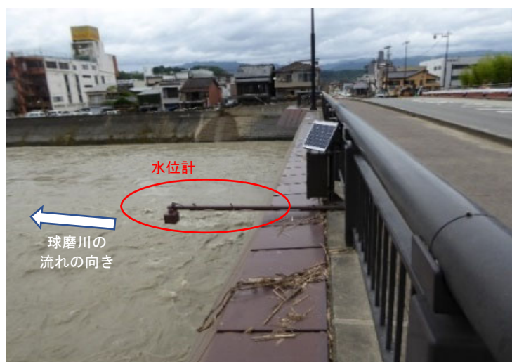
写真1 危機管理型水位計の設置写真
