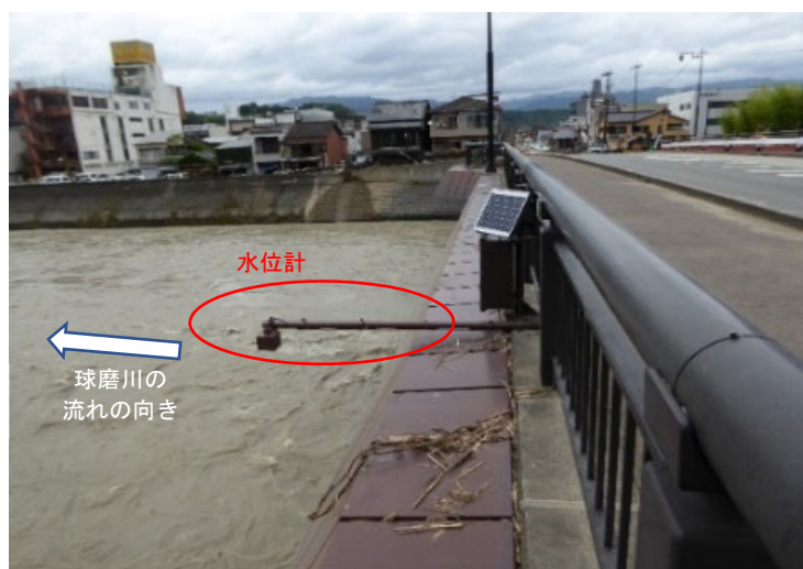
写真1 危機管理型水位計の設置写真
