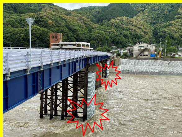
仮橋に河川流入物等が接触
