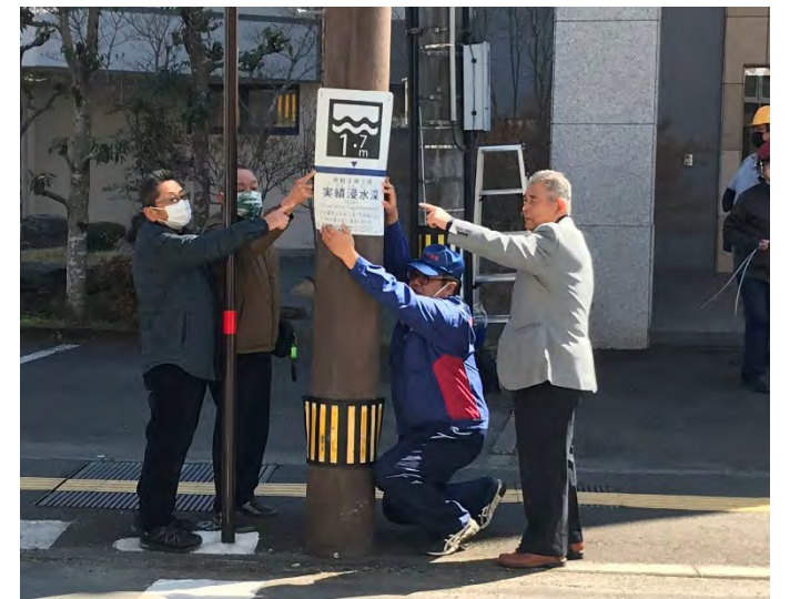
人吉市上青井、中青井、駒井田町と協働で設置 (R5.3.14)
