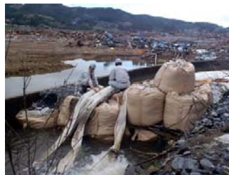
東日本大震災での災害派遣要請（平成23年5月） ※水中ポンプを4台稼働しております。
