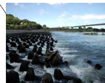
河床低下によって護床ブロックが沈下し、水面との落差を生じている。
