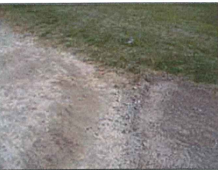
写真2: 北内郭の北側園路に生じた段差。車いすがタイヤを取られ、非常に危険である。
