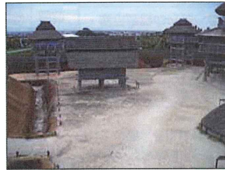
写真4: 北内郭の内部の状況。水みちによる段差が生じている。
