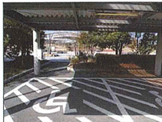
写真4: 誘導サイン等がなく、身障者用駐車場の位置がわかりにくい。
