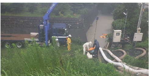
排水状況(大川市大字大野島) 7/10 9時～20時
