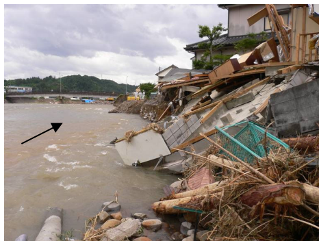
川沿いの家屋が倒壊し流失 坂本橋上流右岸
