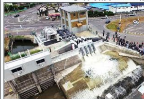
① 石塚雨水ポンプ場
