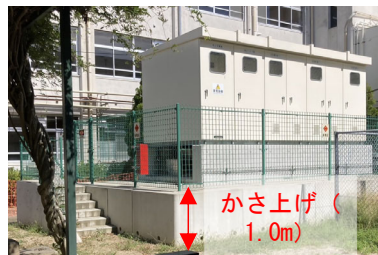
【第2受変電設備】
