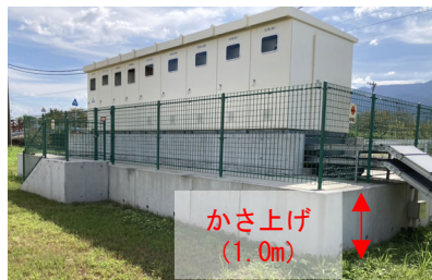
【第1受変電設備】
