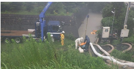
排水状況(佐賀市諸富町大字徳富) 7/10 9時~20時
