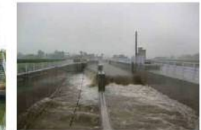
(排水分水ゲート)
