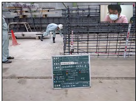
【立会状況画面（現場側）】
