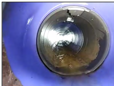
【オンライン検査（管の通り確認）】
