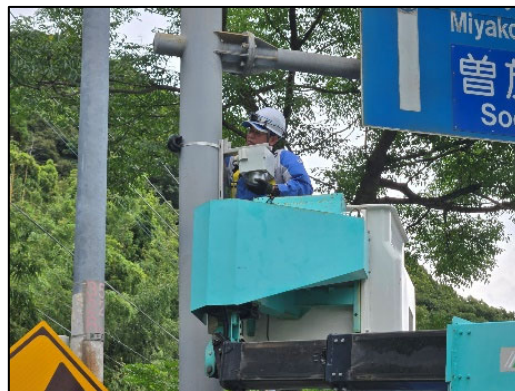
【Web監視カメラ設置】
