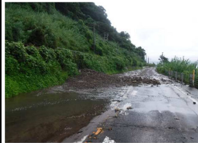
土砂流入(白浜付近)
