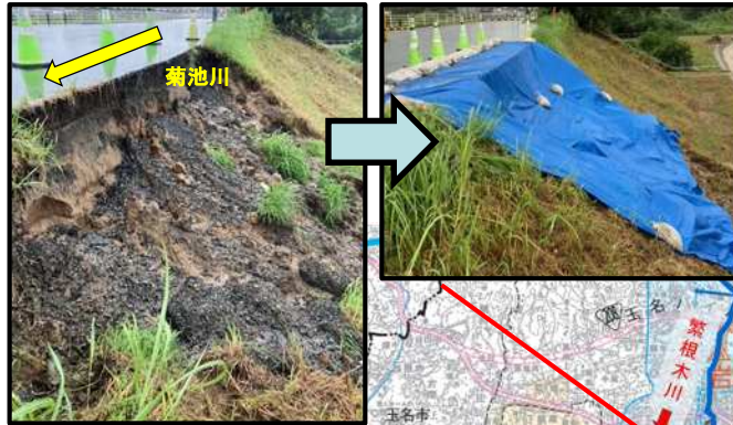
玉名市繁根木地先(繁根木川右岸0k400 付近)
