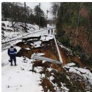
道路被害状況の調査
