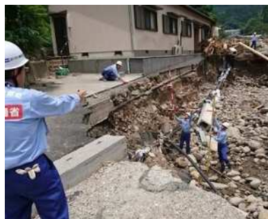
河川被害状況の調査
