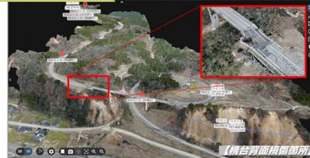
【令和6年能登半島地震】 (石川県珠洲市)
