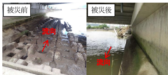
写真-3 根固めブロックの流出状況
