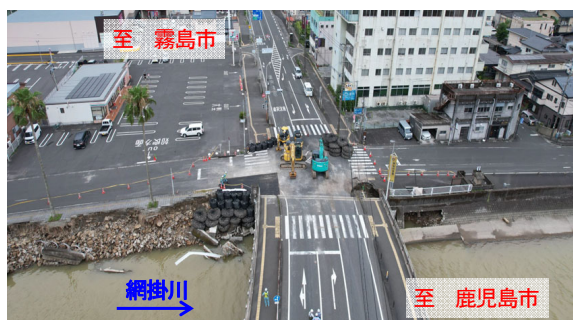
写真-1 被災状況
