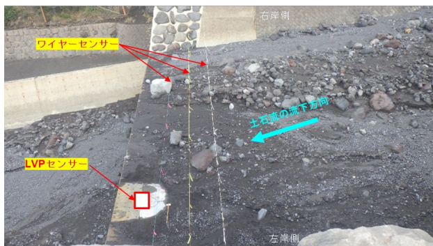
図-3 LVP センサー設置状況（野尻川 7 号堰堤）
