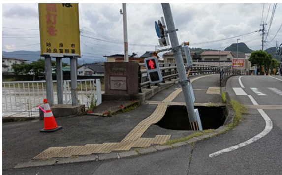
写真-2 A1橋台背面の洗掘状況
