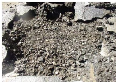
写真-1 粒状化事例（出典：国土交通省航空局，2014）
