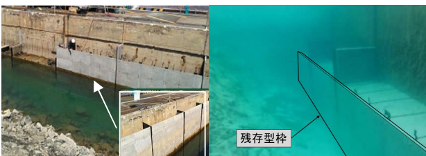
写真-18 残存型枠
