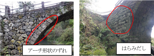
写真-1 アーチ形状の変状と壁石面の変状
