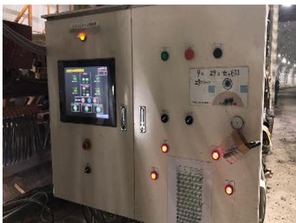
写真-11 制御盤（タッチパネル部）
