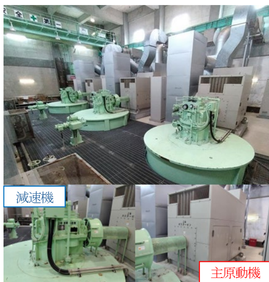
図-2 内田川排水機場 内観
