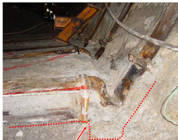
支保工脚部(H鋼)の座屈
