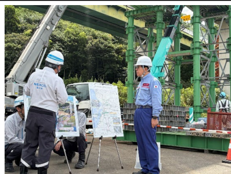
▲八代JCT被災箇所
