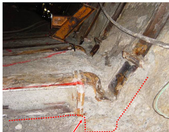
支保工脚部(H鋼)の座屈
