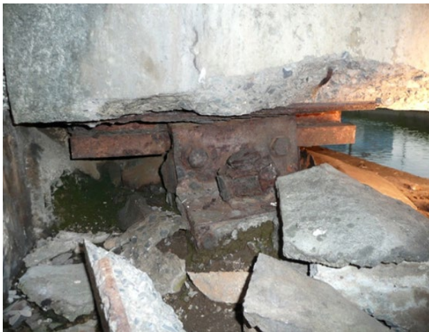
写真-1 老朽化による橋梁の損傷状況
