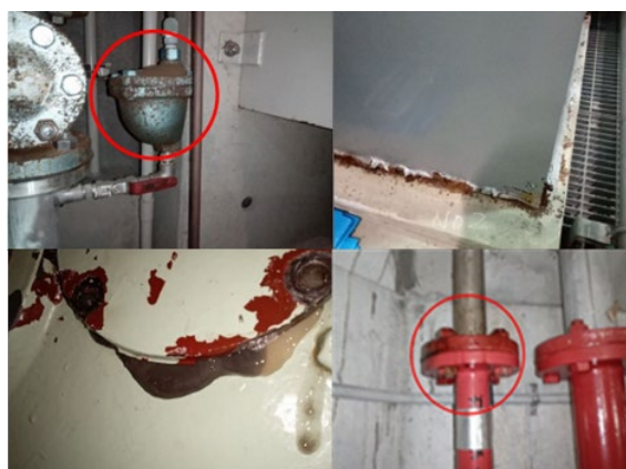
図-3 設備の老朽化
