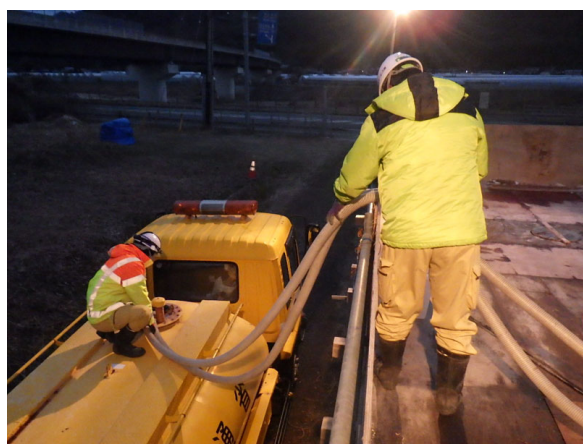
写真－5 塩水生成設備による給水状況
