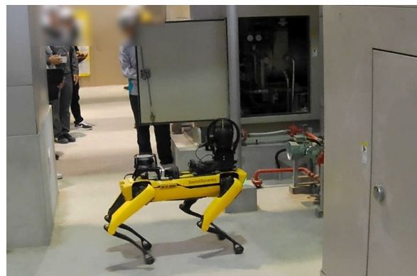
図-10 人が扉の開閉を行いロボットがガスタービン内を点検している様子
