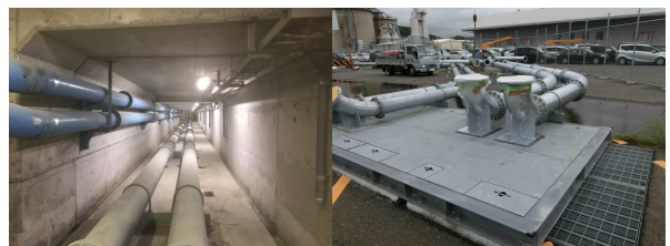
写真-12 既設配管 (埋設)
