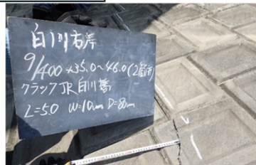
護岸に生じたクラック（右岸 9k400 付近）
