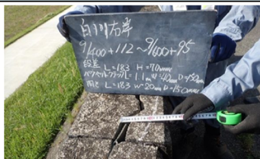
パラペット天端のクラック（右岸 9k500 付近）
