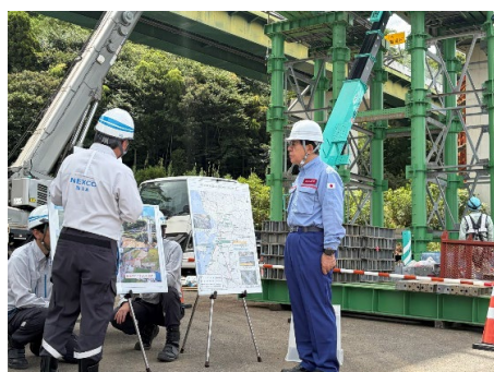
▲八代JCT被災箇所
