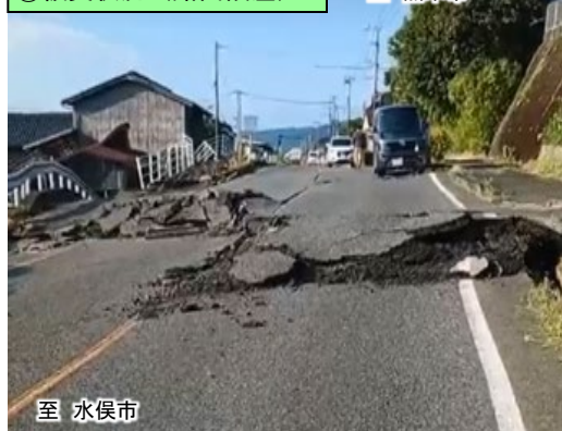
②被災状況（路面段差）
