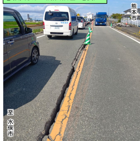
④被災状況（路面段差・亀裂）
