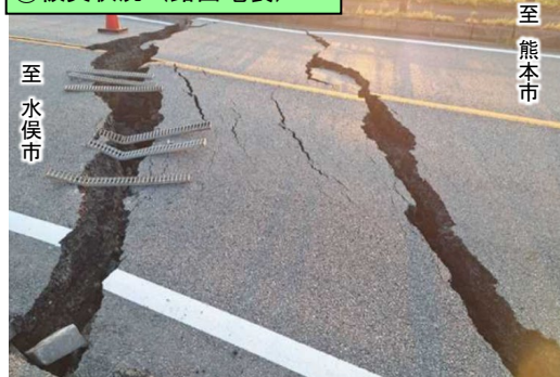
①被災状況（路面亀裂）
