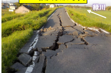
H28被災状況写真
