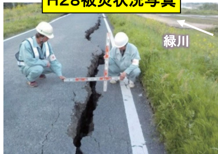
H28被災状況写真
