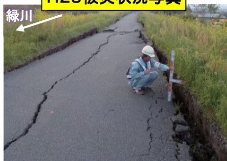
H28被災状況写真
