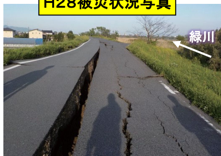
H28被災状況写真
