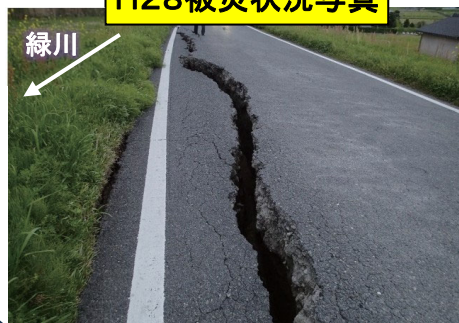
H28被災状況写真
