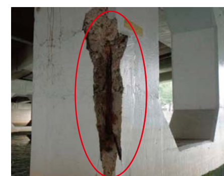
春吉橋の損傷状況：コンクリート剥離・鉄筋露出
