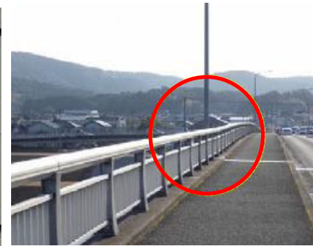
▲中央ヒンジ部の垂れ下がり
