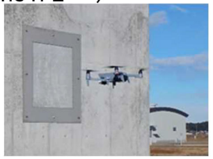
ドローンによる損傷把握
