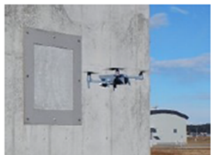
ドローンによる損傷把握
