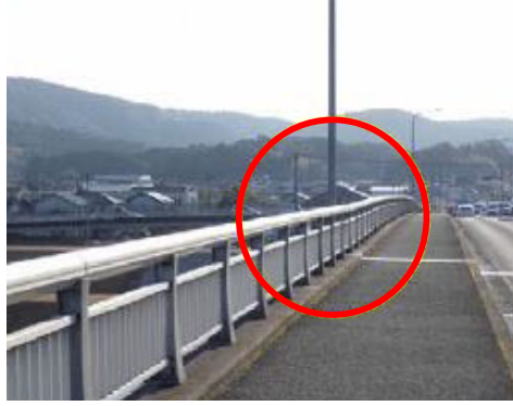
▲中央ヒンジ部の垂れ下がり
