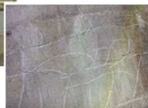
下部工のひび割れ
