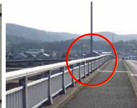
▲中央ヒンジ部の垂れ下がり
