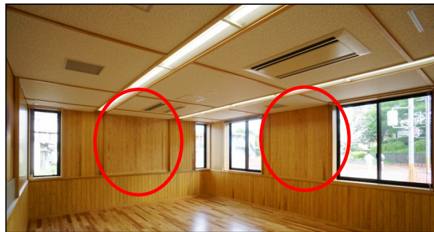
会議室（壁にCLT（直交集成材）を採用）
