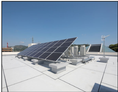
延岡労働総合庁舎 （太陽光発電設備） 【令和4年度完成】
