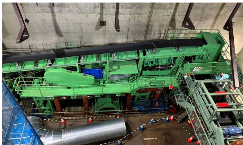
立坑内に配置した連続コンベアメインドライブ
